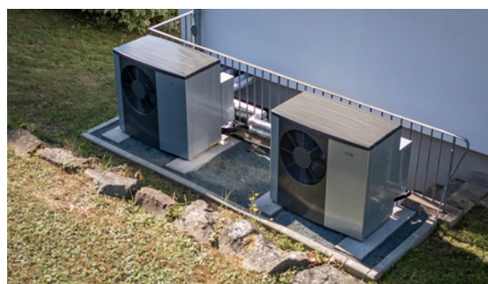
Waldgirmeser Str. 15 bis 17 - Wärmepumpen
